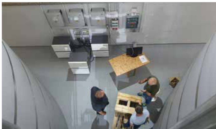
Hochwasserbehälter in Hungen: Autarke Energieversorgung
