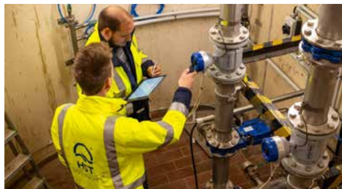
Digitale Anlagenkennzeichnung unterstützt den Service
