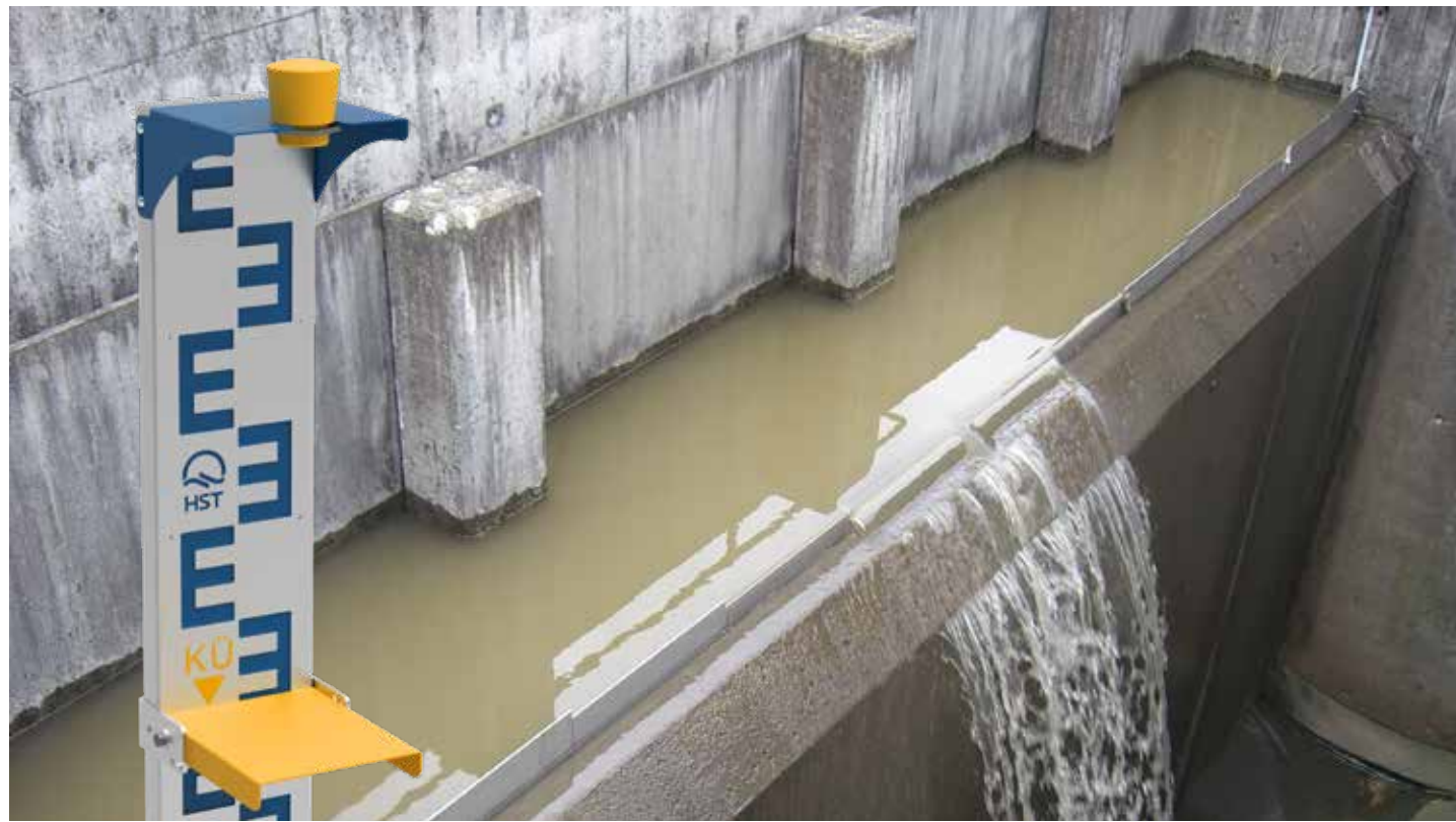
Beckenüberlauf eines Regenüberlaufbeckens mit SensoMatic-EMA -Messprofil
