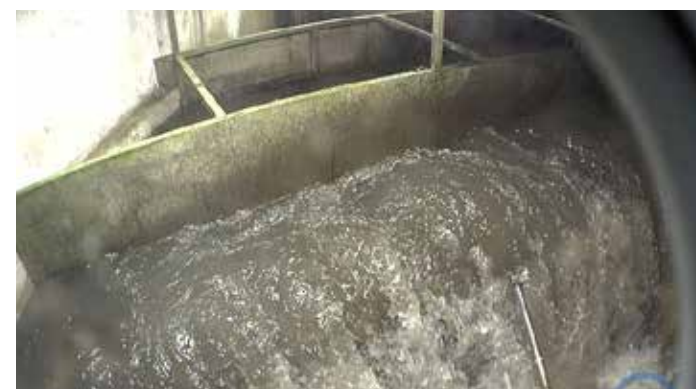
Überlaufereignis im Bauwerk
