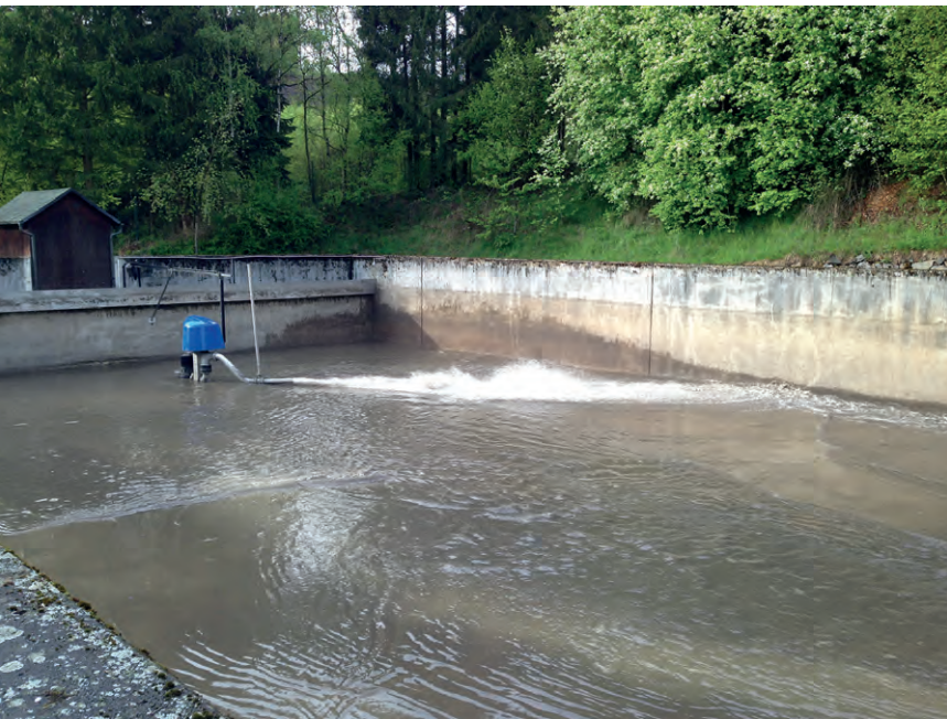
Bild 4: Smarter Schwenk- strahlreiner in einem Regenbecken. © HST Systemtechnik GmbH & Co. KG
